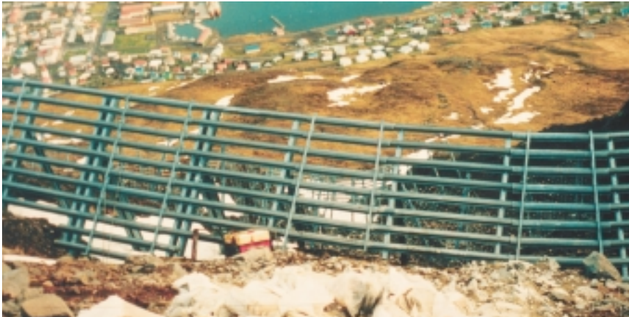
Stoðvirki úr stáli á upptakasvæði snjóflóða á Siglufirði.
